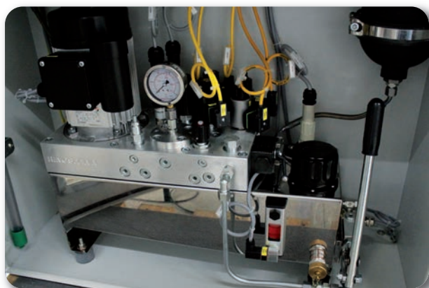
Unidad de alimentación hidráulica
